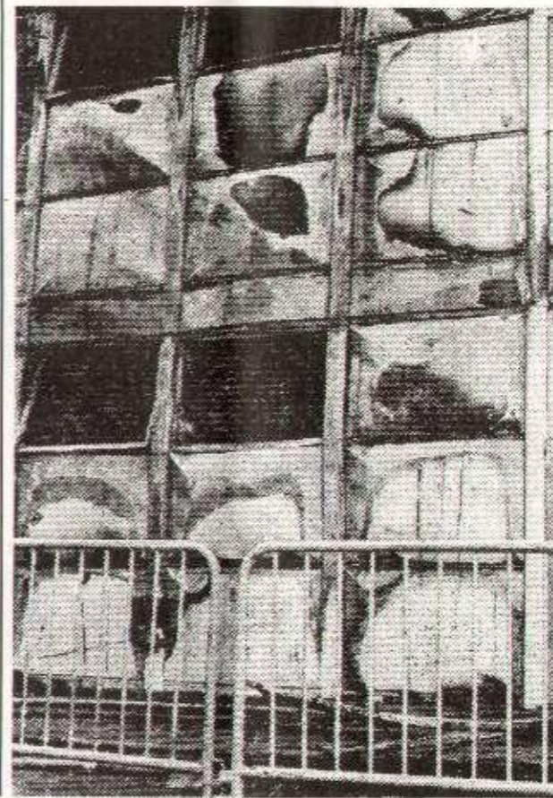
À la Celle-St-Cloud, le mercredi 23 novembre, un lycée du modèle «Pailleron» flambait. Heureusement, du fait que le lycée était vide, il n'y eut aucune victime. Il existe en France à l'heure actuelle 56 lycées construits sur ce modèle.
